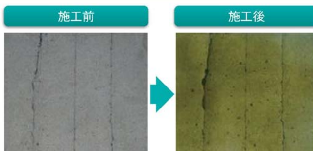
意図的にひび割れを発生させたコンクリート平板上の可視性を確認しました。 ※可視性は下地状況により変動する場合があります。
